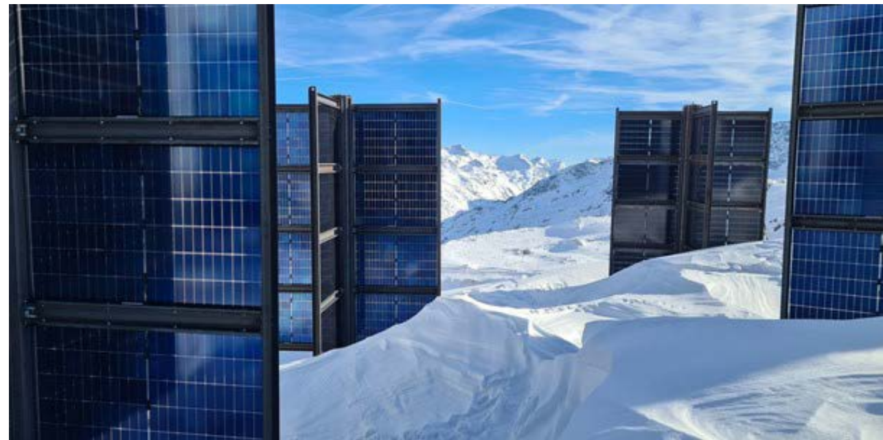
Abbildung 7: Photovoltaik-Anlage von Helioplant® am Tiefenbachgletscher im Ötztal
